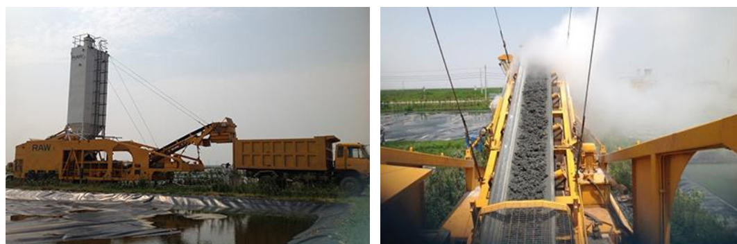
图2.1-1 高速异位土壤处理设备
