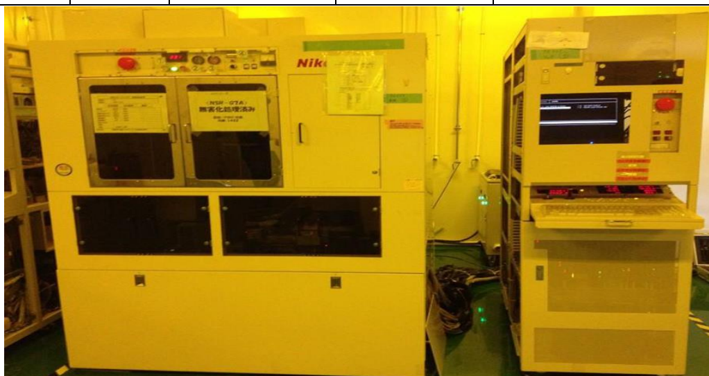
NSR1755G7A（光刻机）设备整体外观图
