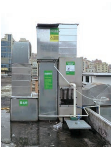
圖：廣州安森廠廢氣治理設施
