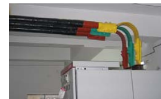
母线与大容量快速开关柜连接
